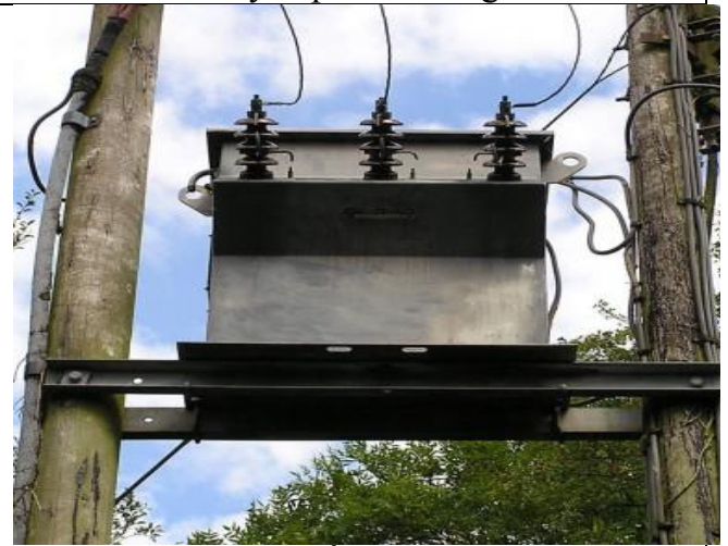
Trạm biến áp 3 pha
